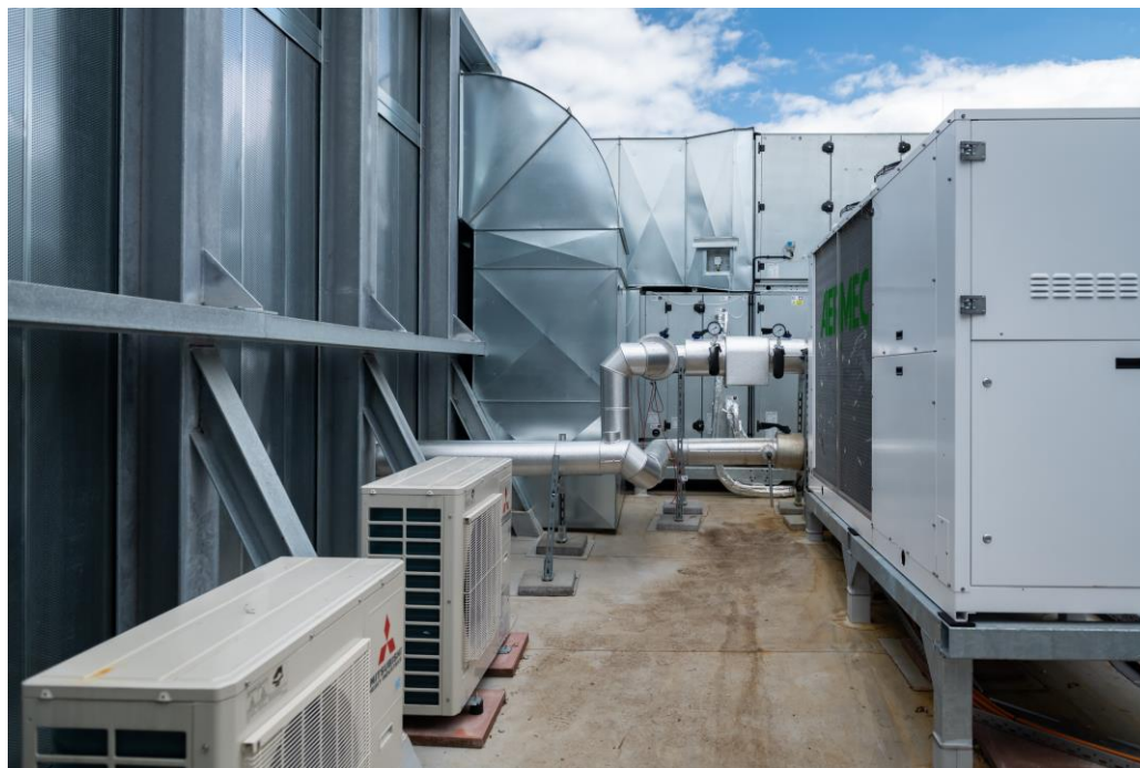
Technologie VZT a chlazení na střeše objektu
